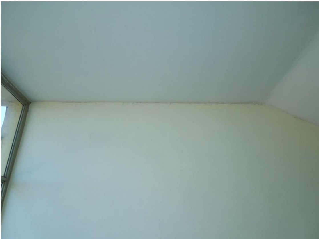
Foto 34: Stato di manutenzione – elementi divisori (tramezzature)
