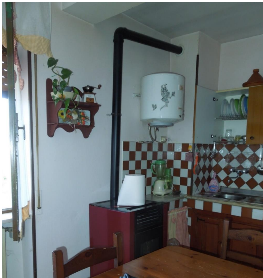
Foto 28: Elementi dell'impianto esistente scaldabagno elettrico e stufa a pellet
