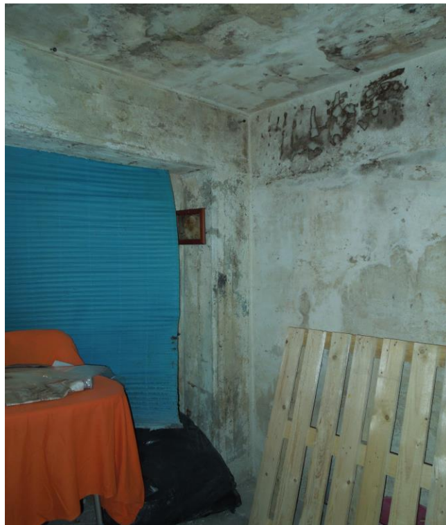
Foto 37: Stato di manutenzione – danneggiamento strutturale
