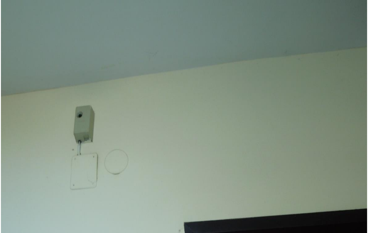
Foto 31: Stato di manutenzione – impianto elettrico
