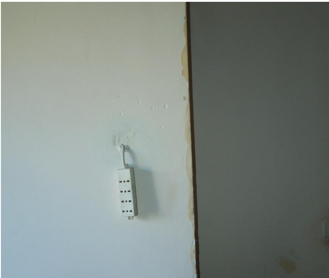
Foto 36: Stato di manutenzione – impianto elettrico negli appartamenti
