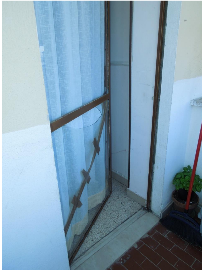
Foto 36: Stato di manutenzione – infissi esterni degli appartamenti
