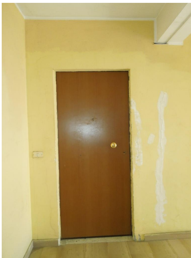
Foto 38: Stato di manutenzione – infissi e tramezzature su parti non riscaldate
