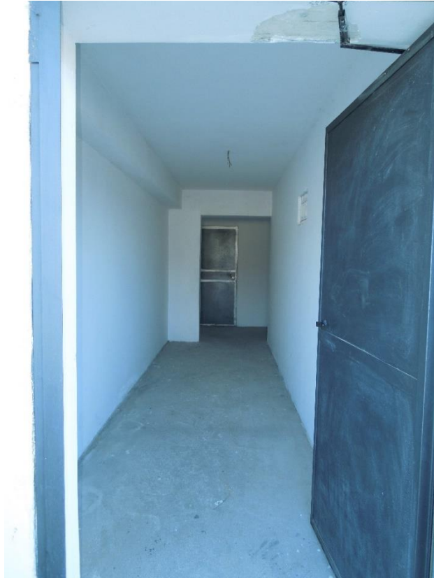
Foto 5: Involucro termico opaco e trasparente con caratteristiche degli accessi ai locali condominiali
