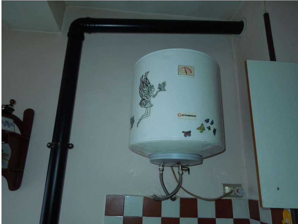
Foto 27: Elementi dell'impianto esistente scaldabagno elettrico
