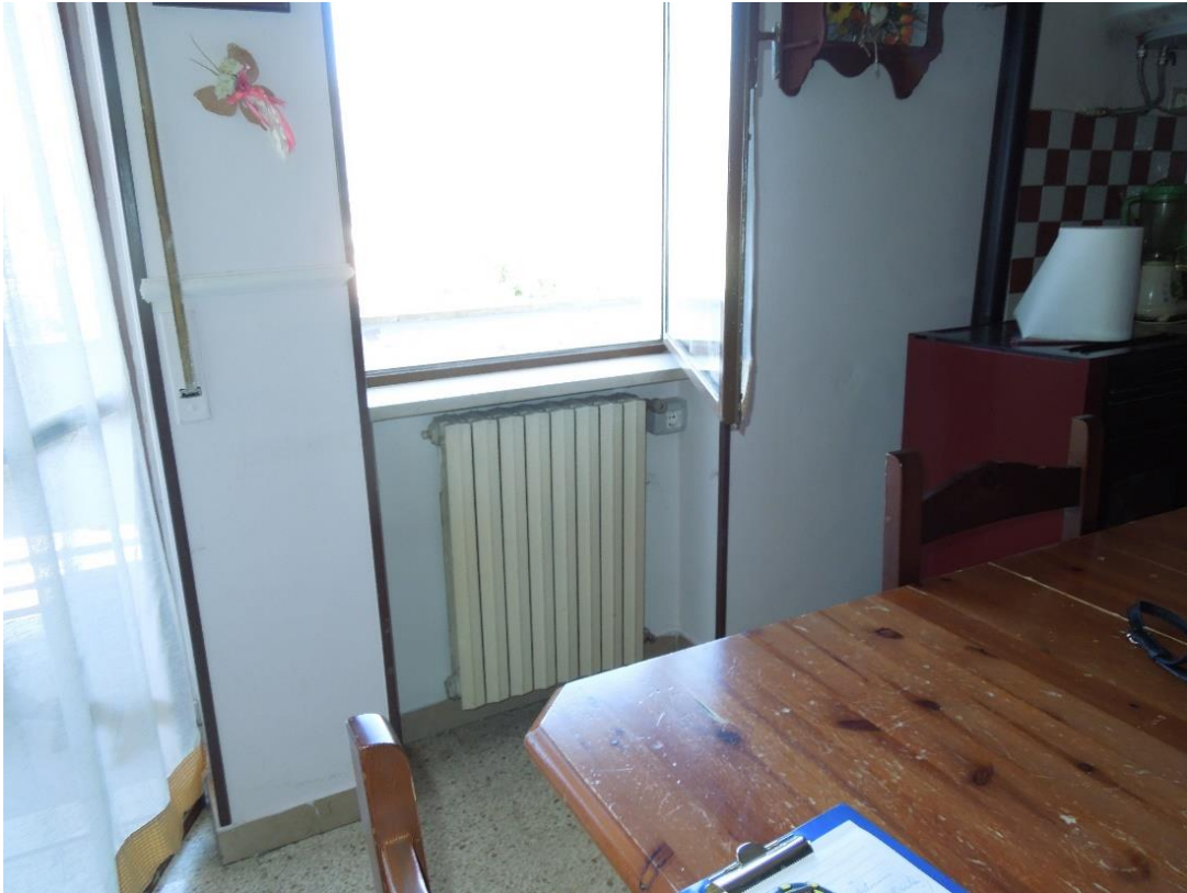
Foto 29: Elementi dell'impianto esistente - sistema di emissione a radiatori (non in uso)
