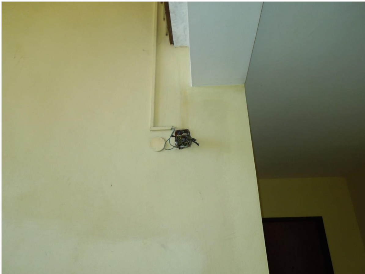
Foto 30: Stato di manutenzione – impianto elettrico
