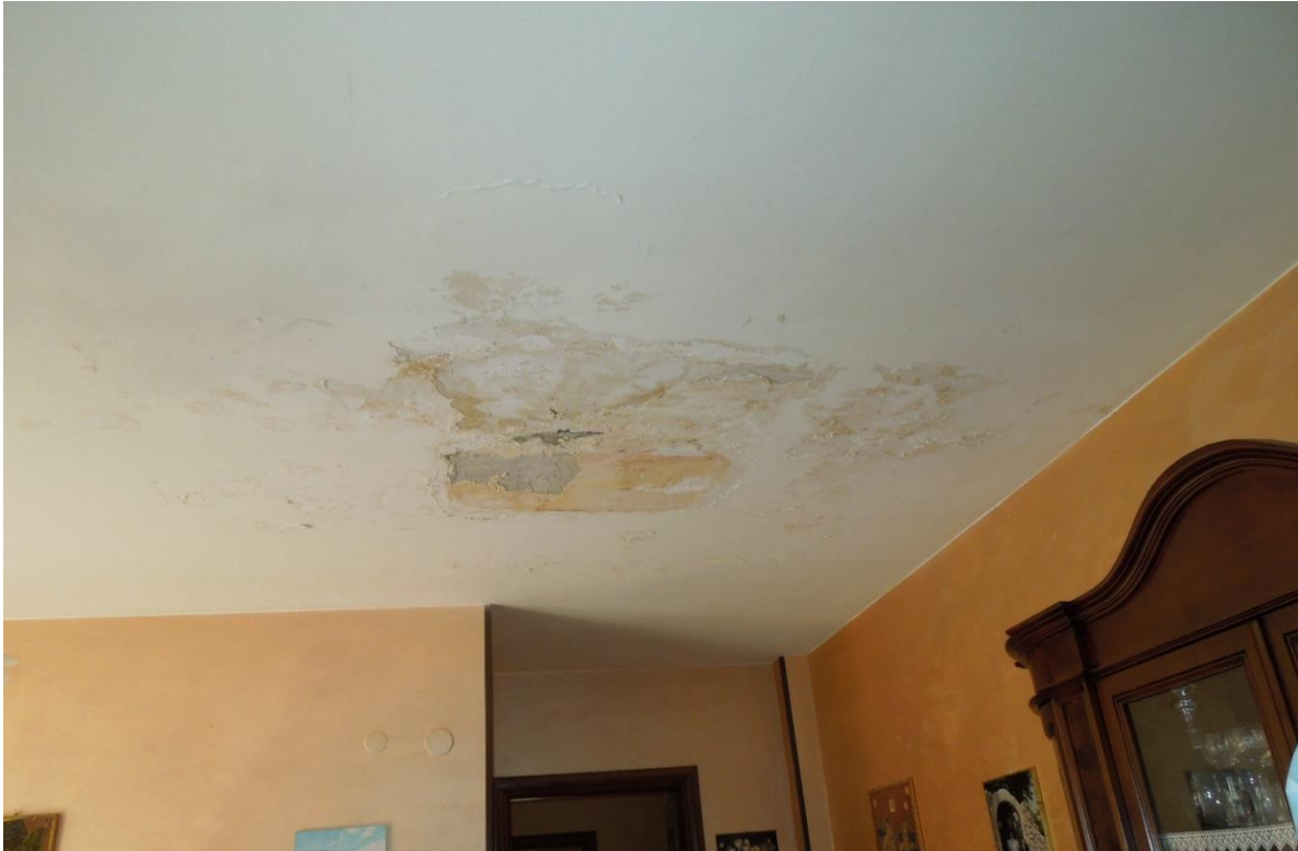
Foto 35: Stato di manutenzione – elementi divisori (solai d'interpiano)
