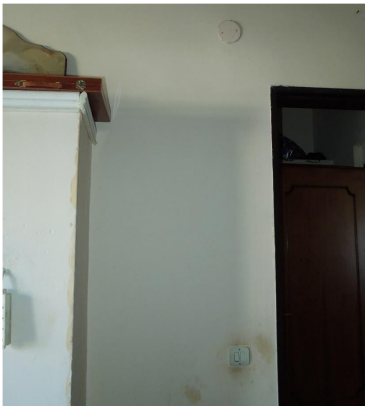
Foto 37: Stato di manutenzione – impianto elettrico negli appartamenti
