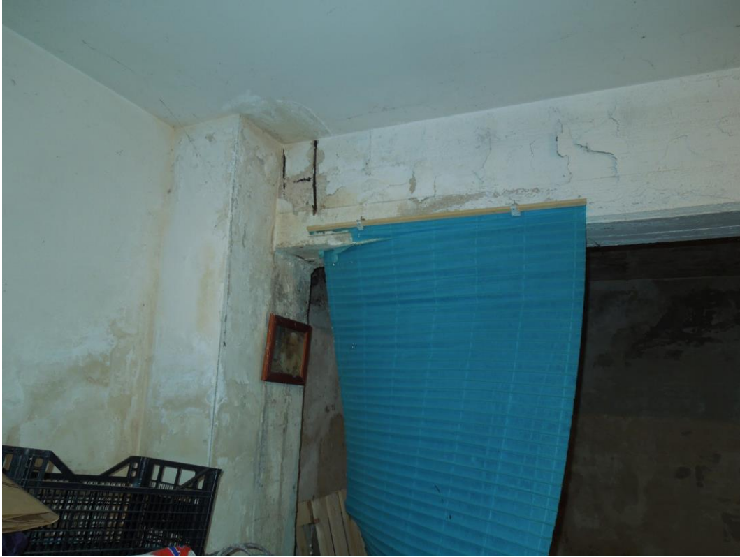
Foto 38: Stato di manutenzione – danneggiamento strutturale
